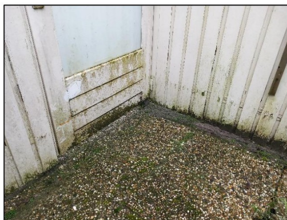
Foto B: Ruimte onder de deur in de achtertuin van woning nr. 4
