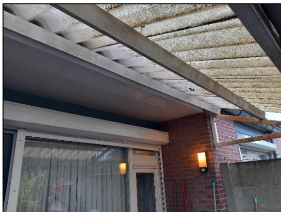
Foto G: Ruimte onder golfplaten in achtertuin van woning nr. 6
