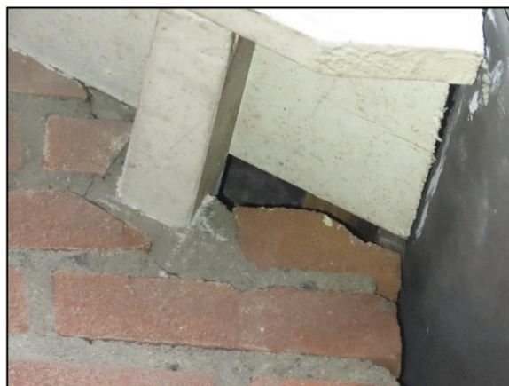
Foto B: Gat in muur van woning nr. 4
