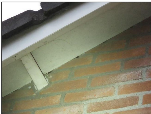
Foto A: Gat in muur bij voegsel, bij woning nr. 8 (onbewoond)
