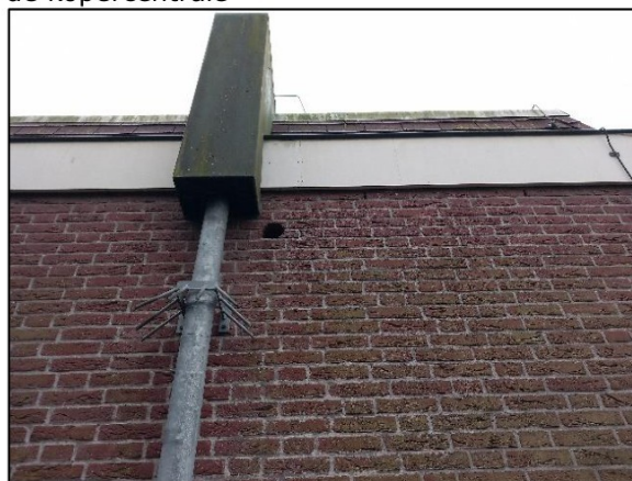
Foto D: Groot rond gat in muur, aan de noordzijde van de kopercentrale
