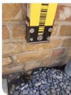
Meetboutje in de gevel
