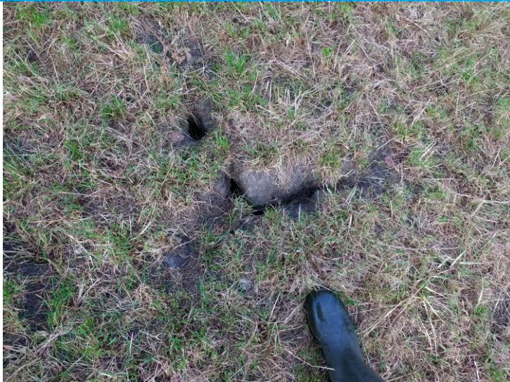
Foto 11. Scheuren in talud wielerbaan
