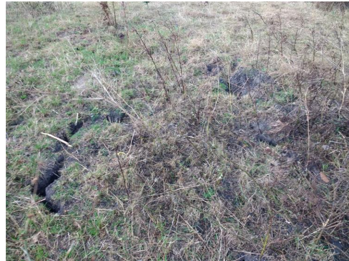
Foto 12. Scheuren in talud wielerbaan
