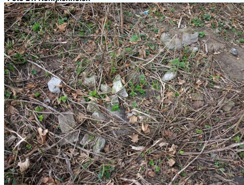
Foto 23. Puin op maaiveld
