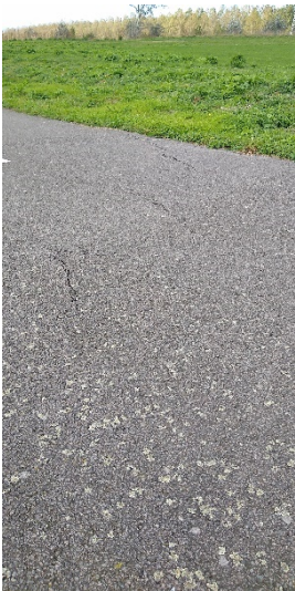
Foto 86 fietspad bobbels en scheuren
