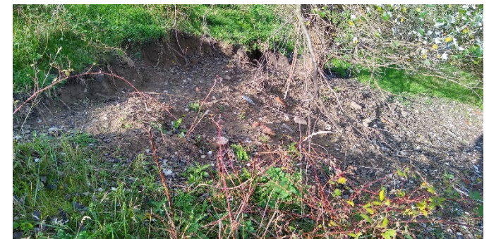
Foto 87b verschuiving in talud
