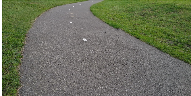
Foto 84 Verzakkingen in het asfalt
