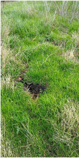
Foto 11 Scheuren bij talud wielerbaan
