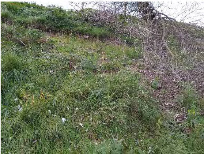
Foto 52: 87a verschuiving in talud
