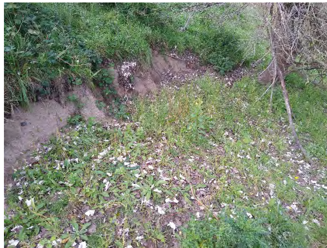
Foto 53: 87b verschuiving in talud
