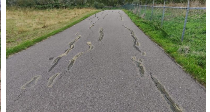
Foto 33: 52 Scheuren wielerbaan nemen toe
