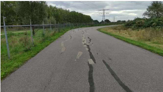
Foto 34: 53 Scheuren wielerbaan nemen toe
