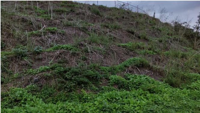
Foto 61: 152 Talud, risico op verzakking
