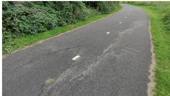
Foto 71: 165 Asfalt niet hersteld
