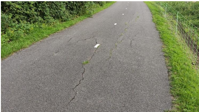
Foto 70: 165 Meer asfaltscheuren, niet hersteld
