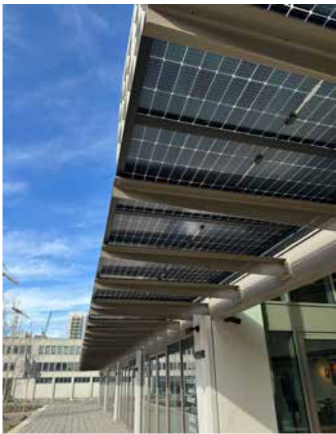
Zonnepanelen geïntegreerd in een luifel
