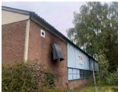
Op het pand is een asbest-verdachte dakbedekking aanwezig. Onder de druppelzone aan de oostzijde is geen goot en verharding aanwezig.
