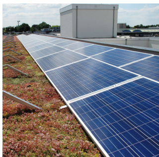
Figuur 33: Bruin vogeldak met zonnepanelen
