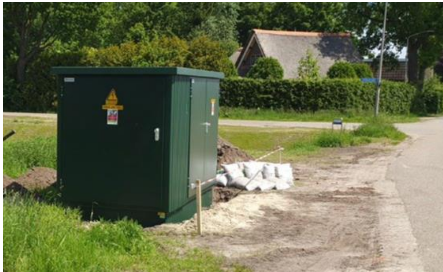
Figuur 4. Transformatorhuisje van Enexis, ter indicatie van de grootte.
