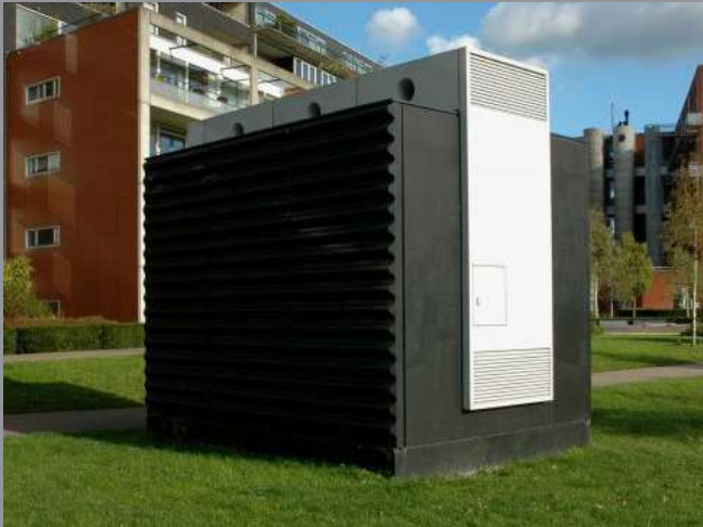
Te plaatsen trafohuisjes zijn donker van kleur waardoor ze minder opvallen
