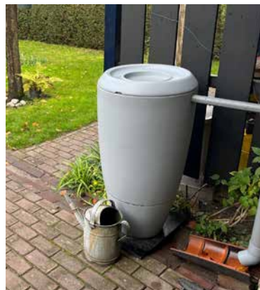
De oplossing van familie Noordzij: regenwater stroomt van het dak eerst de regenton in. Als die vol is, sijpelt het water via een geul naar een wadi.
