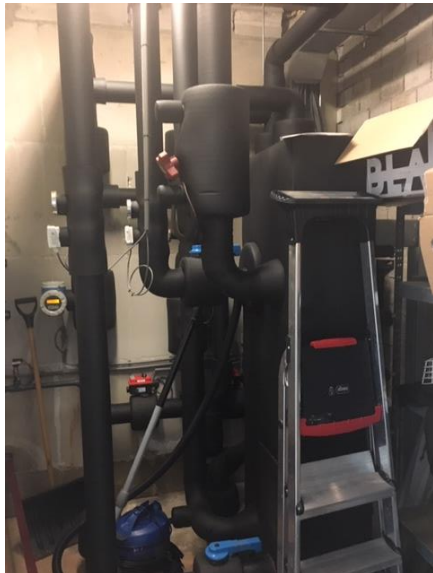
Technische installatie begane grond.
