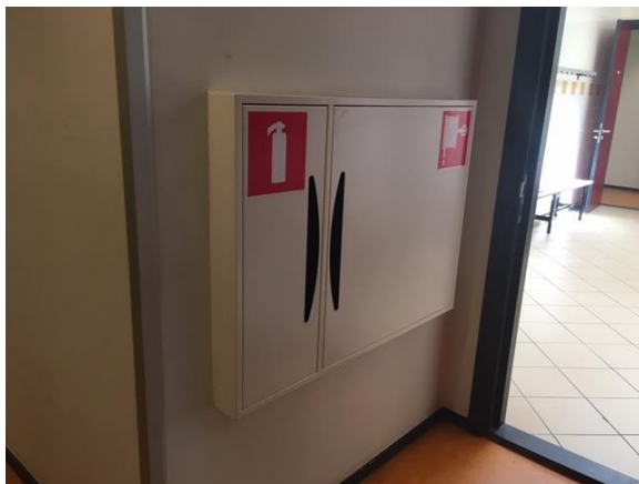
Kast brandslang en draagbaar blustoestel.
