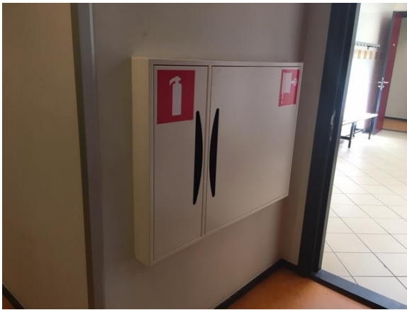
Kast brandslang en draagbaar blustoestel.
