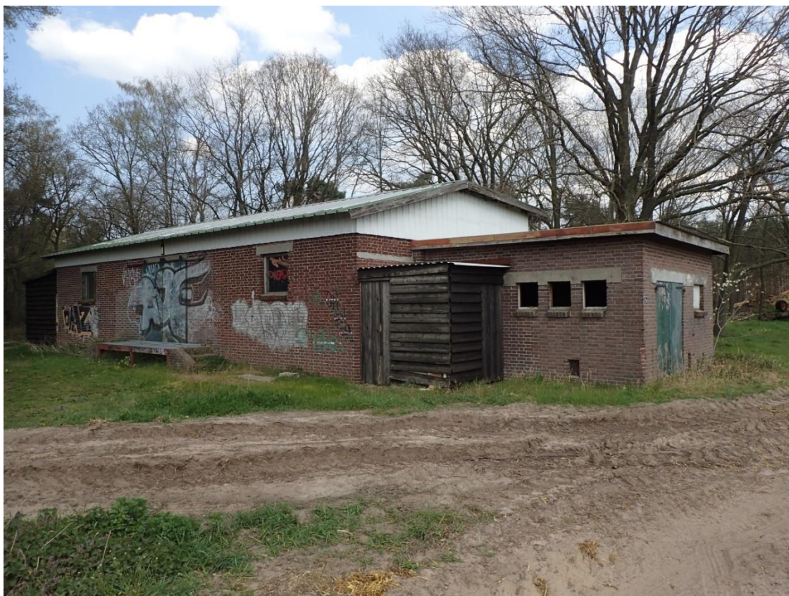
Figuur 119. De Boerenbondsschuur van Vlieden, met nog herkenbaar perron. Na de sloop van het tegenovergelegen Heibergweg 1 in 2020 is het het oudst nog bestaande gebouw in het voormalige gehucht Achterste Beersdonk (foto: RAAP, 8 april 2020).
