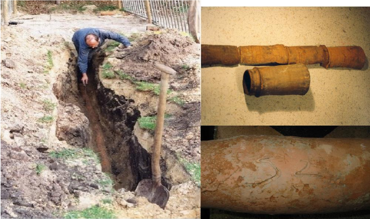
Figuur 22. Opgraving van de kannebuizen waterleiding bij de Hub van Doorneweg met rechts details van de genummerde waterleiding (bron: Deurnewiki).
