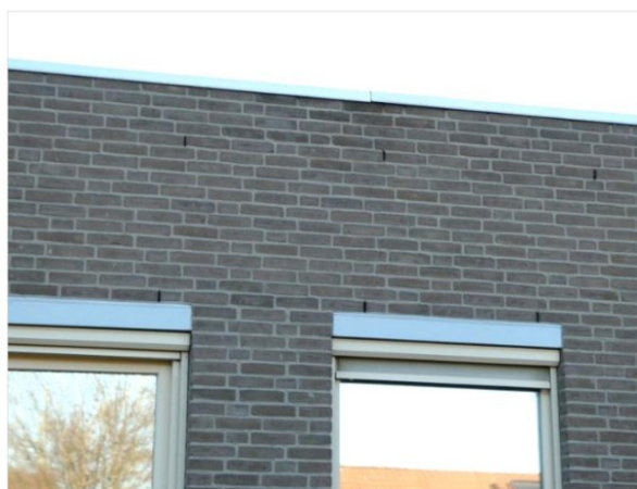
Figuur 4.3 Open stootvoegen aanwezig in de bebouwing op de onderzoekslocatie.
