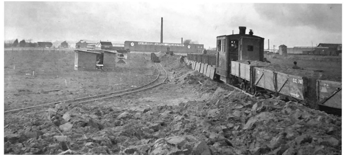
De ophooging van het Hamburgerbroek over een oppervlakte van 9 H.A. is met ruim 80 werklozen der gemeente Doetinchem, onder leiding van den Heer Roos, hoofdopz. der Ned. Heide Mij., ter hand genomen. Per G. T. M. wordt het benodigde zand vanaf de Gaanderensche bulten naar het terrein vervoerd. Op den achtergrond de rubberfabriek „Vredestein”
