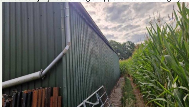
Figuur 11: Dakgoot schuur
