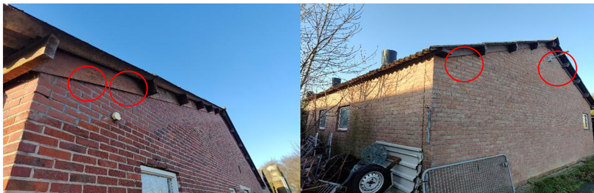
Vleermuizen kunnen een verblijfplaats bezetten achter de daklijsten van de varkensstallen (rode cirkels).
