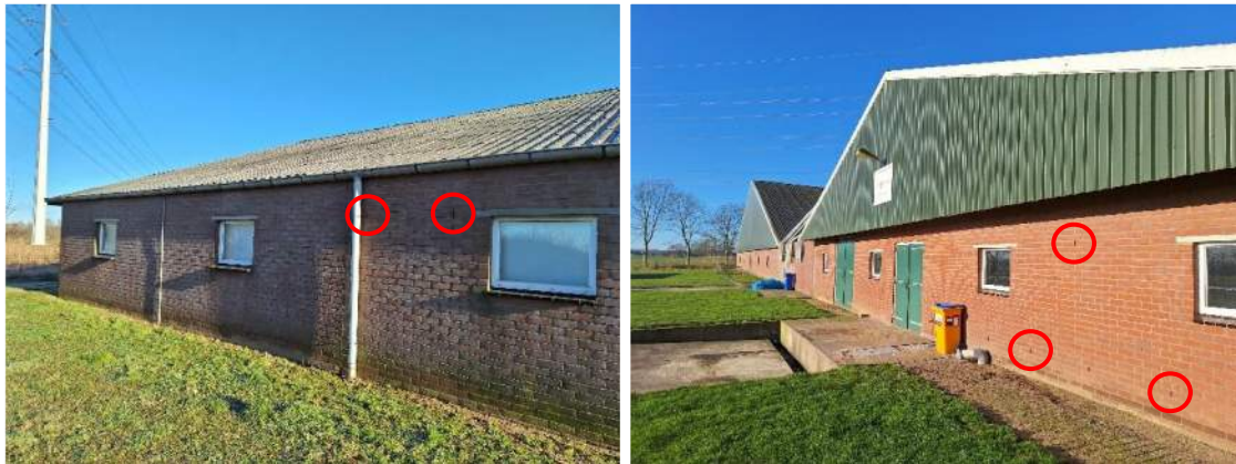
Impressie van de open stootvoegen in de buitengevels van de stallen, zie rode cirkels.
