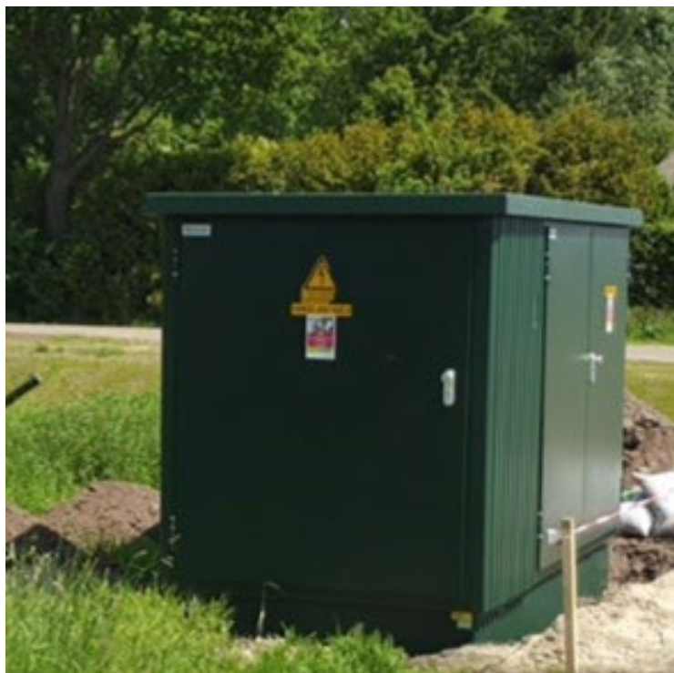
Figuur 11 Voorbeeld van een middenspanningsruimte
