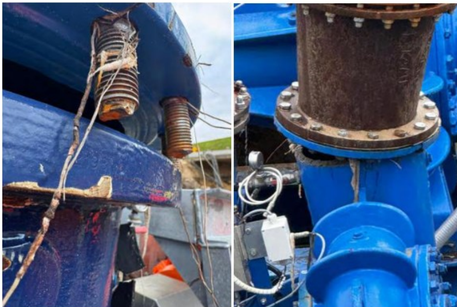
Figuur 10 Schade aan TPI met links: pomp 1 en rechts: pomp 2
