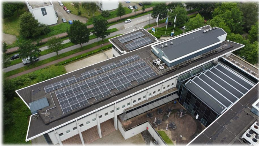
Foto 8.2: De gerealiseerde panelen op het hoofdkantoor, voorzien van een slimme levering aan het gebouw en de laadpalen wagenpark.
