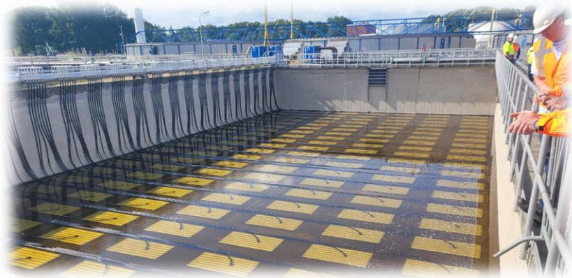
Foto 5.1: De nieuwe beluchtingselementen in één van de drie straten van de rwzi Tilburg. Hierbij zijn schotelbeluchters vervangen door efficiëntere plaatbeluchters.
