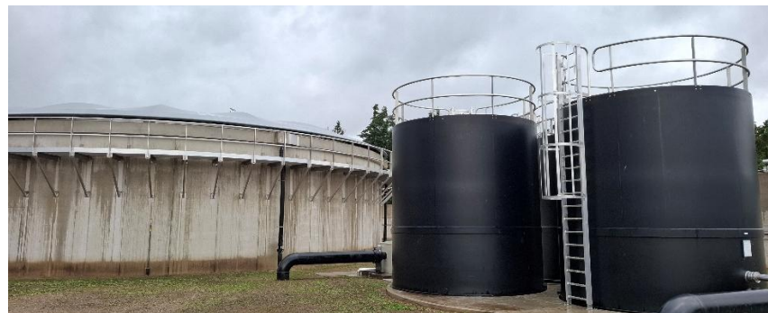
Foto 6.1: De overkapping van de nieuwe VBT en bijbehorende nieuwe luchtbehandelingsinstallatie voor de drie overkapte VBT's op rwzi Boxtel.
