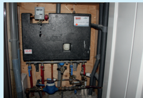
Afleverset in de meterkast van de woning
