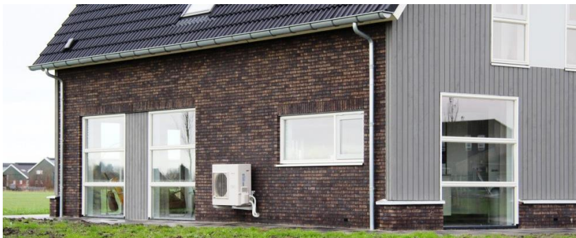
Afbeelding 3.14 Woning met een lucht-waterwarmtepomp
