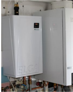
Hybride warmtepomp Buitenlucht als bron ~€6.500 - €8.500
