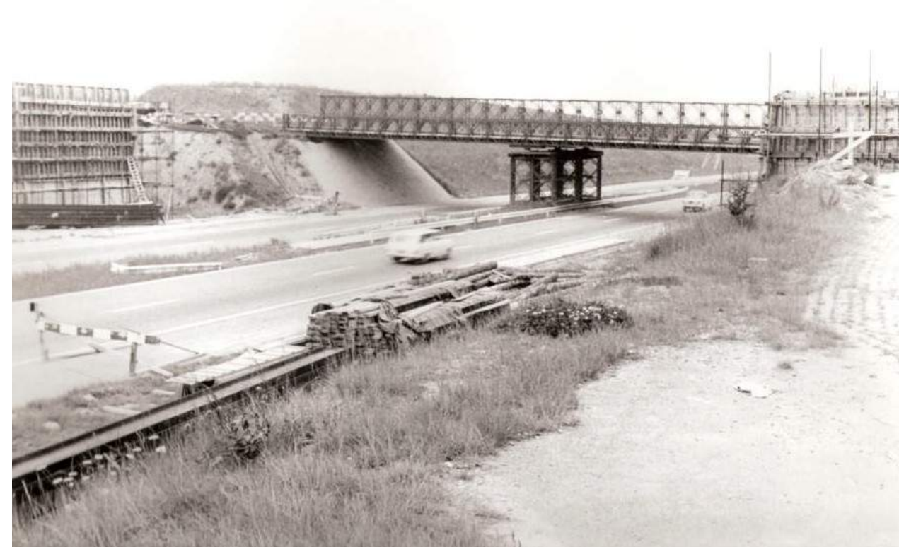
Figuur 12: Tijdelijke Baileybrug over de pas aangelegde A2 ter hoogte van Roosteren 6 .
