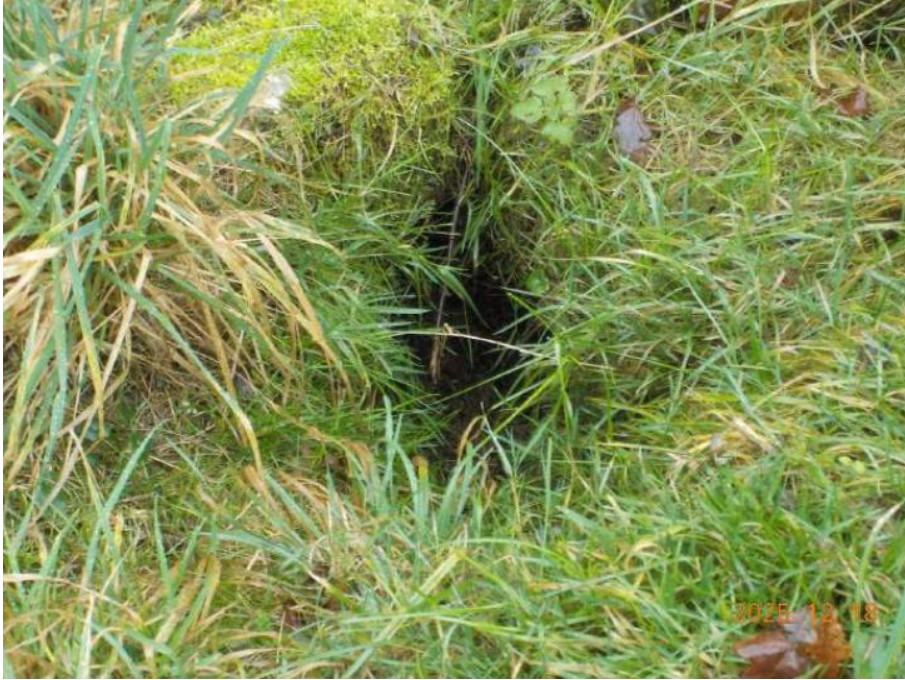
Afbeelding 4: Gaten in huidig talud Alddjip/Beakendyk
