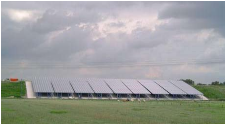
zonnepanelen op vuilstort: Ecopark Waalwijk
