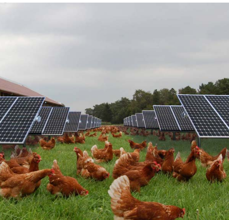
Kippenuitloop met zonnepanelen
