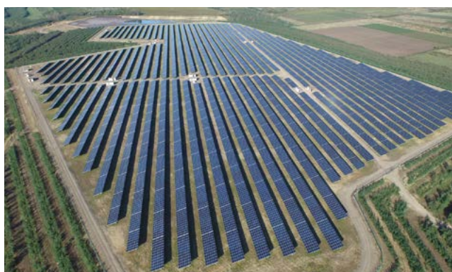
Visonta PV Power Plant, Hongarije
