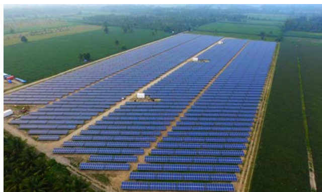
Surallah PV power plant, Filipijnen
