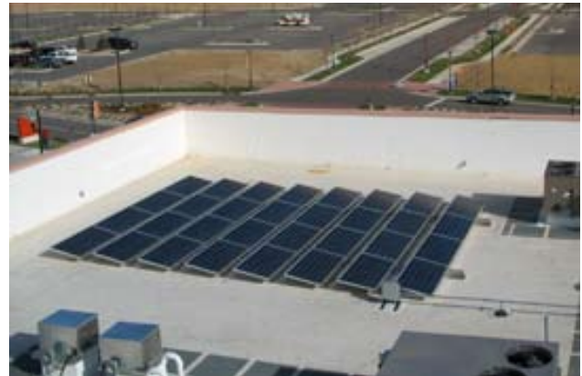
Zonnepanelen op plat dak bedrijventerreinen
