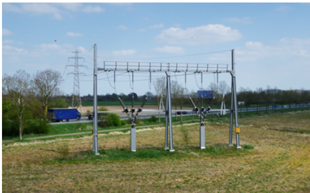
Figuur 2.8 | Afbeelding van een portaal met kabelopstijpunten
