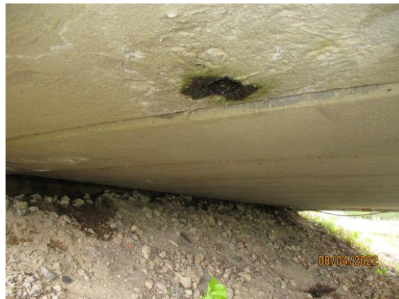
KUNSTWERKEN: 01, 02, 05, 05B, 20, 21, 23 en 26 Schadebeeld: Corroderende of ontbrekende hemelwaterafvoeren. Risico: Ontstaan betonschades ter plaatse van de uitstroom van hemelwater. Maatregel: Vervangen stalen hemelwaterafvoeren.
