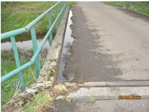
KUNSTWERKEN: 01, 09, 18, 20, 21 en 26 Schadebeeld: Het asfalt is aan het rafelen en er zijn losse delen aanwezig. Risico: Toename rafeling en putvorming in het wegdek. Maatregel: Vervangen bitumineuze verharding.
