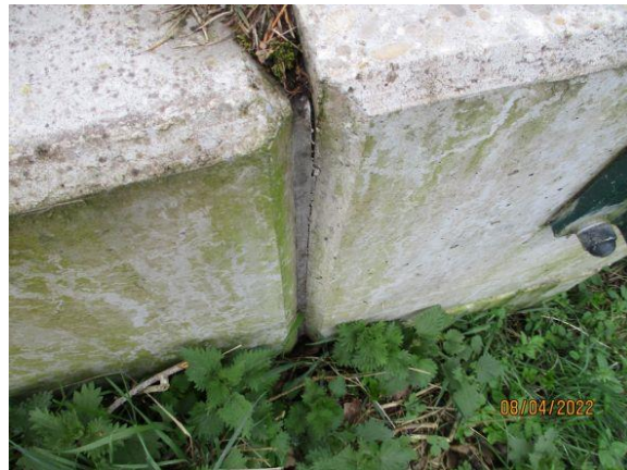
KUNSTWERK: 21, 22, 24 en 26 Schadebeeld: Verouderde, onthechte of verwijderde kitvoegen in dilataties. Risico: Indringing van dooizouten in de onderliggende constructie met mogelijk ontstaan van betonschades. Maatregel: Vervangen van de kitvoegen.
