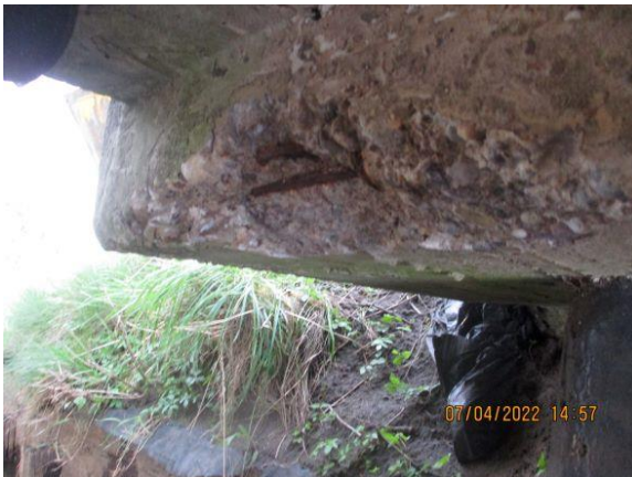
KUNSTWERK 05, 07, 14, 17, 18, 20 en 26 Schadebeeld: Afgesprongen delen beton. Risico: Bezijken deel van constructie Maatregel: Herstellen betonschade conform de richtlijnen van de CUR118.
