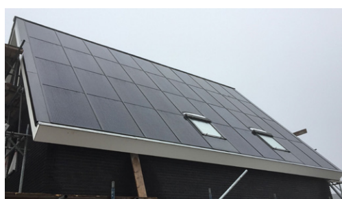
PV-panelen als dakvlak
