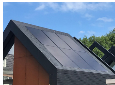
Geïntegreerde pv-panelen binnen dakvlak
