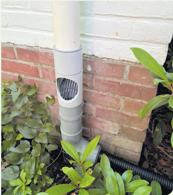
Afgekoppelde regenpijp met een bladvanger die voorkomt dat de pijp verstopt raakt.
