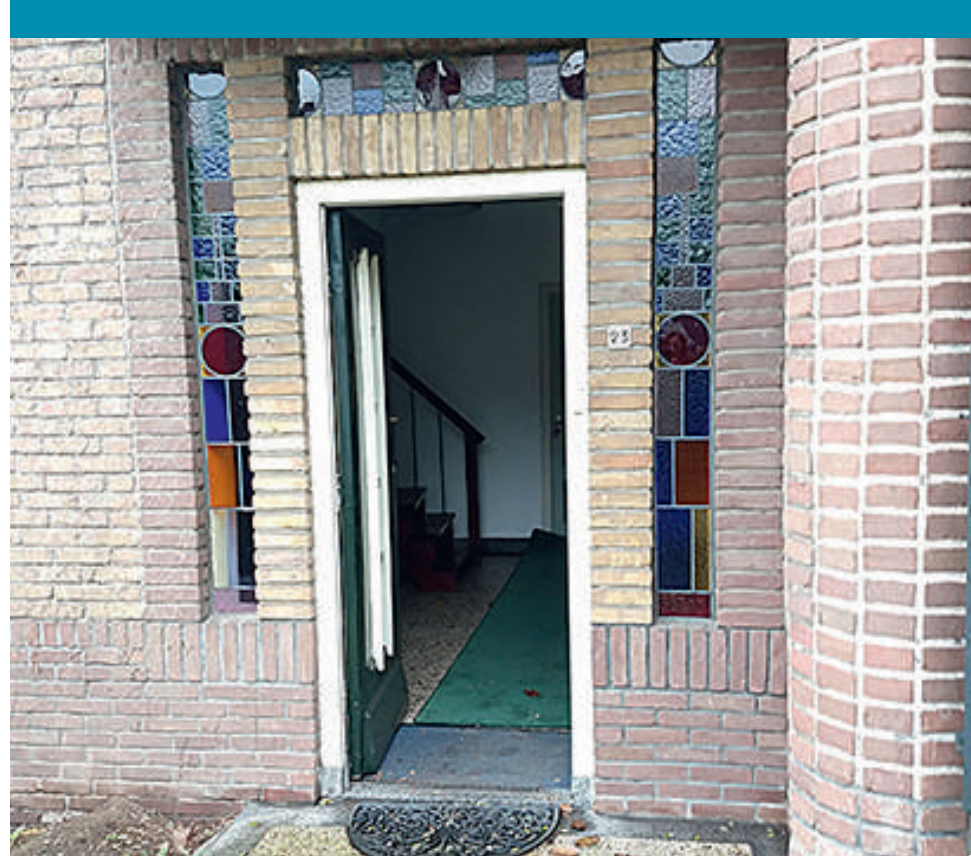
| Entree van een woonhuis in Amsterdamse School stijl met spouwmuur aan de straat Zandvoort in Amerongen
