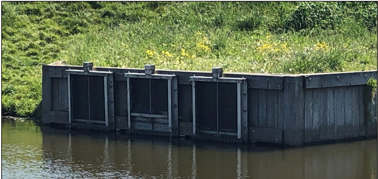
Figuur 19 – 3 naast elkaar gelegen inlaten met afsluiters
