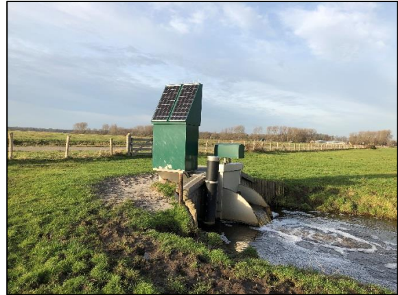
Figuur 9 – geautomatiseerde uitlaat van de berging
