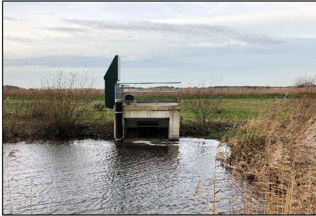
Figuur 8 – geautomatiseerde inlaat van de berging
