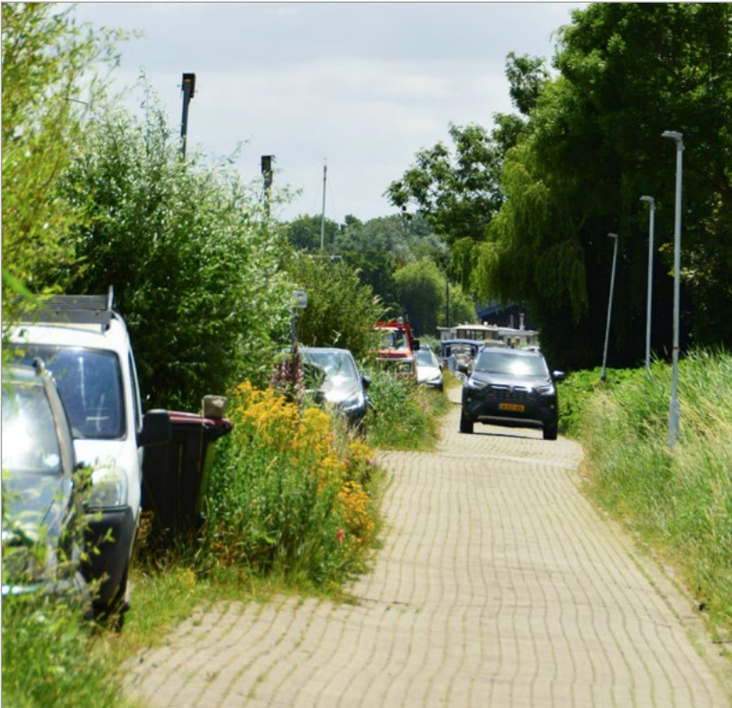
Afbeelding 5 Verzakking van verharding en lichtmasten.
