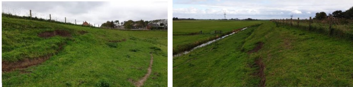
Figuur 2.2 Scheuren en vervorming in de Purmerdijk bij Ilpendam
