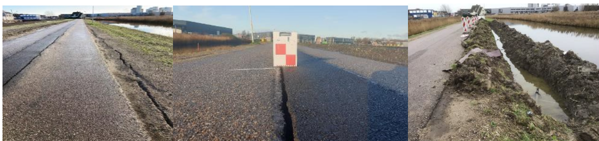
Figuur 2.3. Lengtescheuren in de Noorddijk van Wormerveer.
