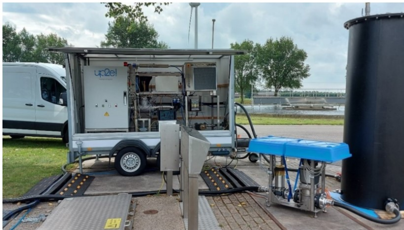
Figuur 6.4. De pilot installatie Roturi systeem op Wervershoof.
