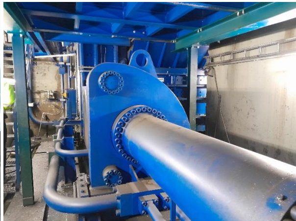
Figuur 1.7: Kelder onder noordelijke bedrijfshal met zware apparatuur.
