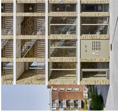
Boven: afwijkende vakkulling. Beneden: onderbreking sokkel.
