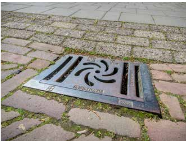
Via deze kolk stroomt het regenwater in de waterberging onder de straat
