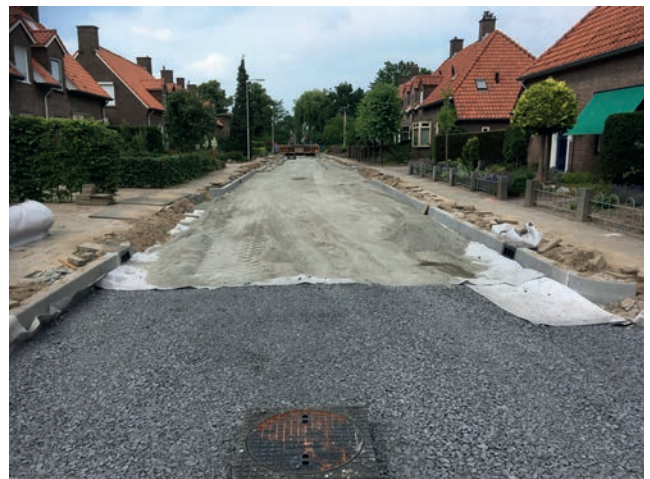
Een pakket van steenslag onder de straat. Tussen deze stenen kan veel regenwater worden geborgen
