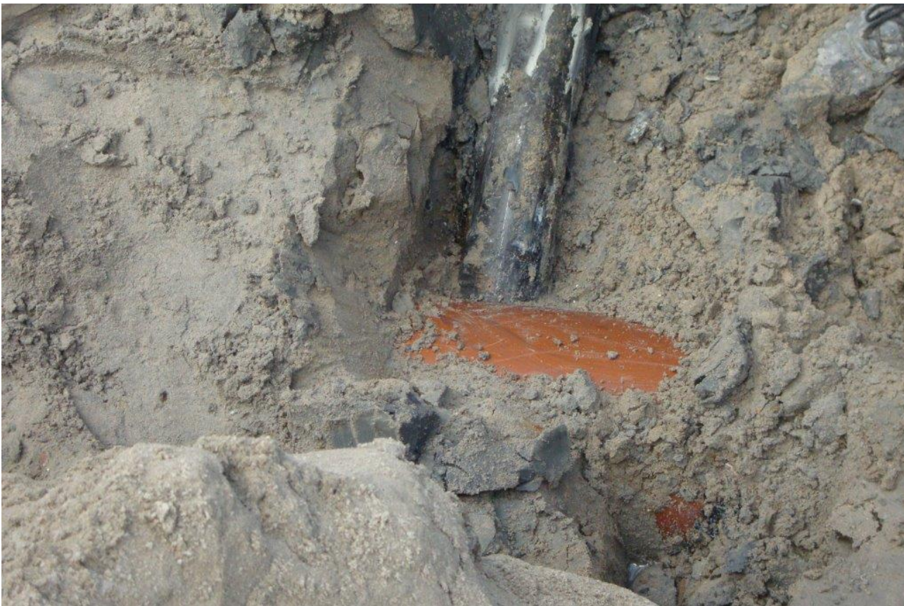
Figuur 7: Er gaat ook weleens wat mis. In deze situatie is een gestuurde boring dwars door een bestaande buis heen geboord
