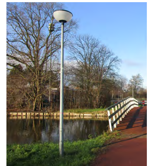
armatuur fietspad (innolumus ariane)
