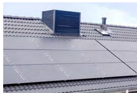
PV panelen en luchtwarmtepomp
