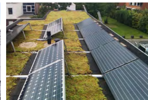
PV panelen groen dak
