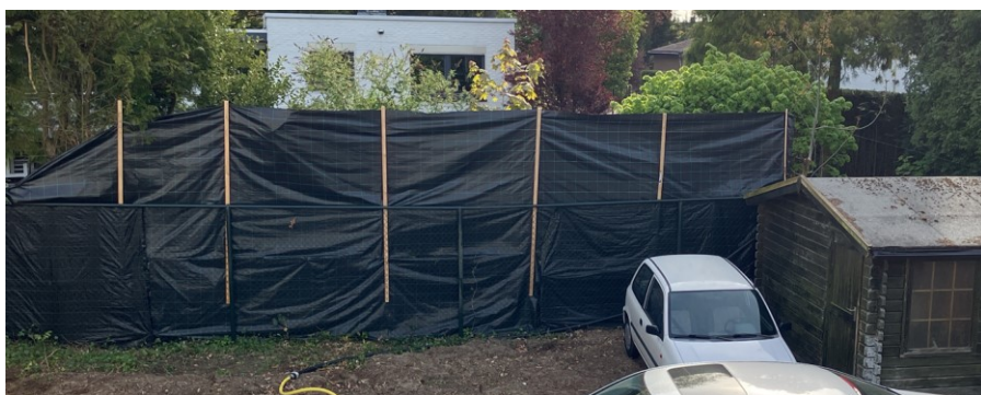
Erfafscheiding bestaand uit armoedig materiaal gebruik
