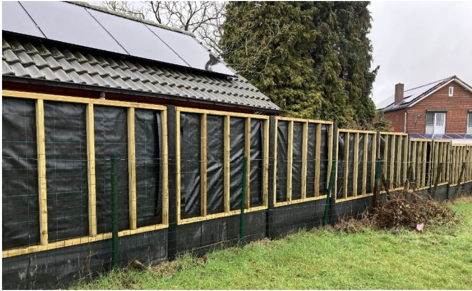
Een erfafscheiding bestaande uit een armoedig materiaalgebruik
