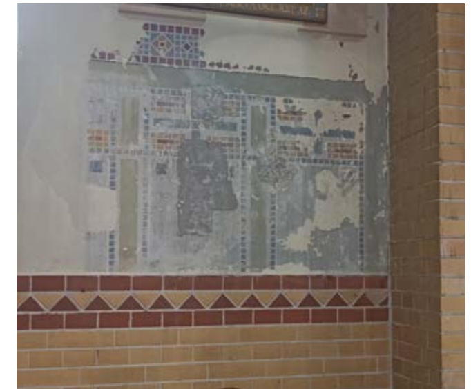
Afbeelding 148 Plaatselijk is het oude schilderwerk zichtbaar
